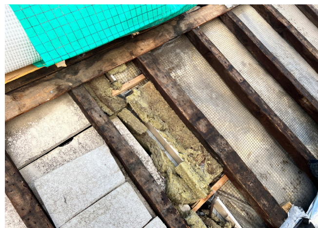
Chantier avec malfaçons
